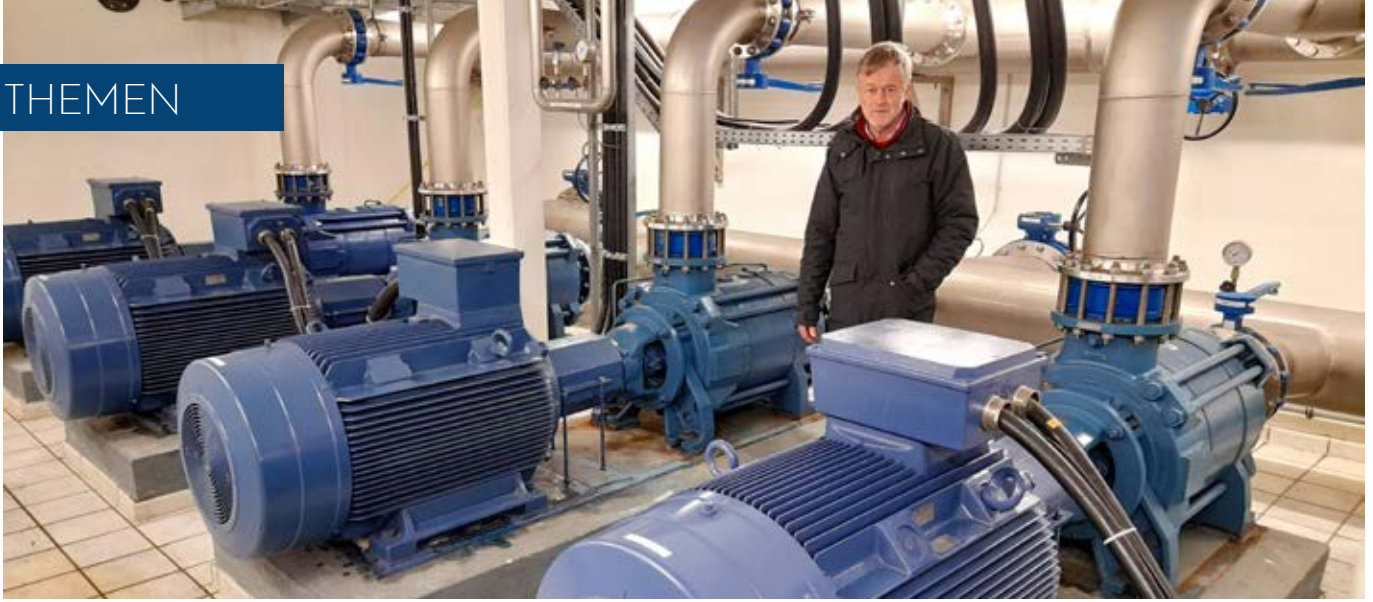
Die Pumpen bewegen das Wasser aus der Zuckerfabrik in den Wasserspeicher Stöcken.
